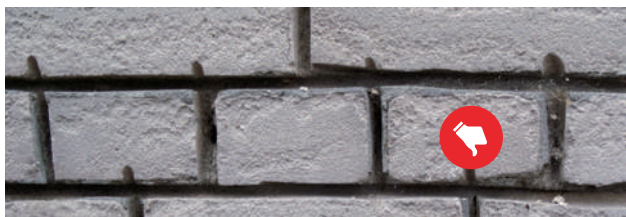
Brique abimée par l'usage de la disqueuse pour les joints verticaux.
